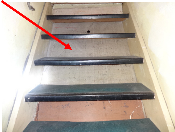
Afbeelding 13: nr 47 kerk/ binnenzijde/plaat onderzijde keldertrap
