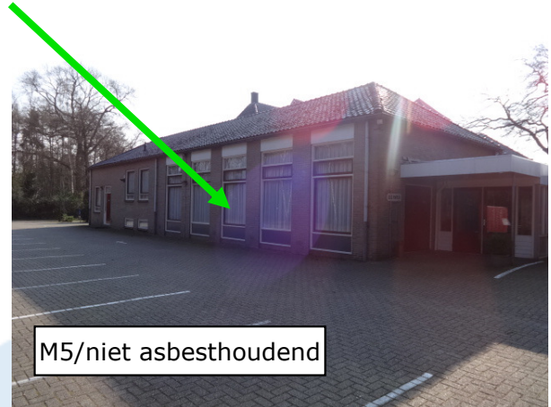
Afbeelding 8: nr 47 kerk/ buitenzijde/beglazingskit ramen met enkelglas
