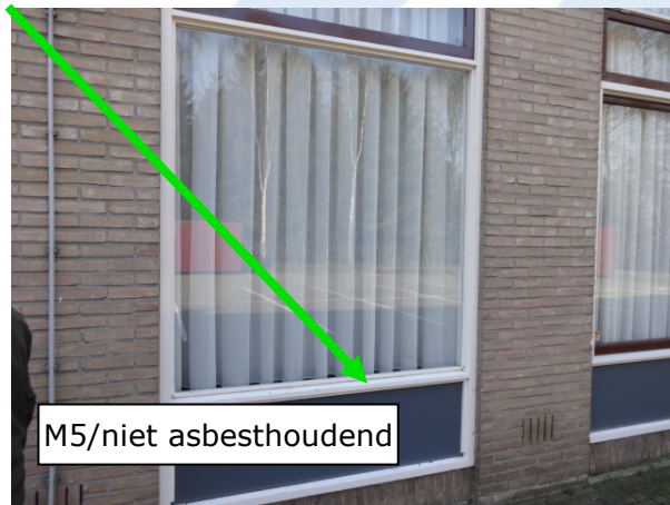
Afbeelding 9: nr 47 kerk/ buitenzijde/beglazingskit ramen met enkelglas
