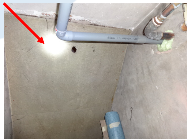
Afbeelding 12: nr 47 kerk/ binnenzijde/plaat onderzijde keldertrap
