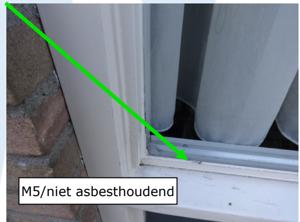
Afbeelding 10: nr 47 kerk/ buitenzijde/beglazingskit ramen met enkelglas
