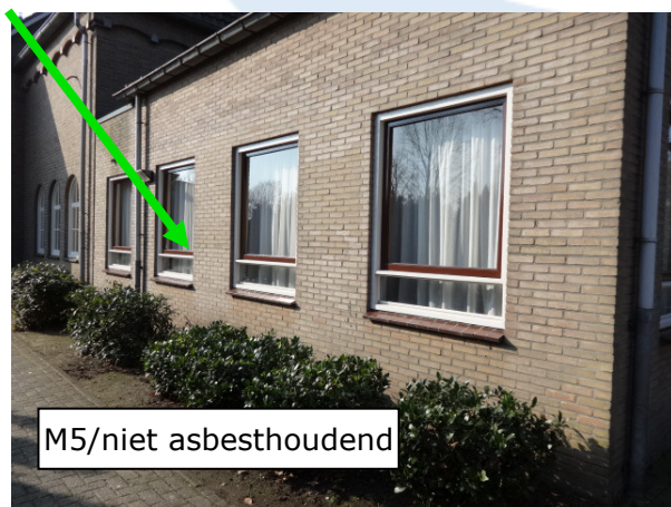
Afbeelding 11: nr 47 kerk/ buitenzijde/beglazingskit ramen met enkelglas
